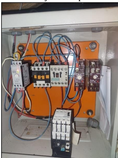
Figura 7 – Conjunto de painel elétrico
