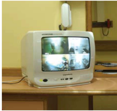
Figura 4: Monitor do circuito interno de câmera de vídeo
