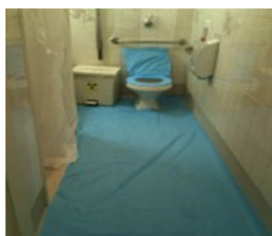
Figura 3: Sanitário do quarto terapêutico
